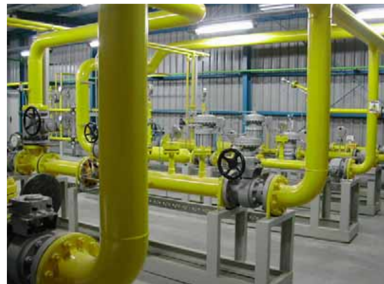
Imagen de la estación de regulación y medida de gas. Foto: Zabalgarbi
